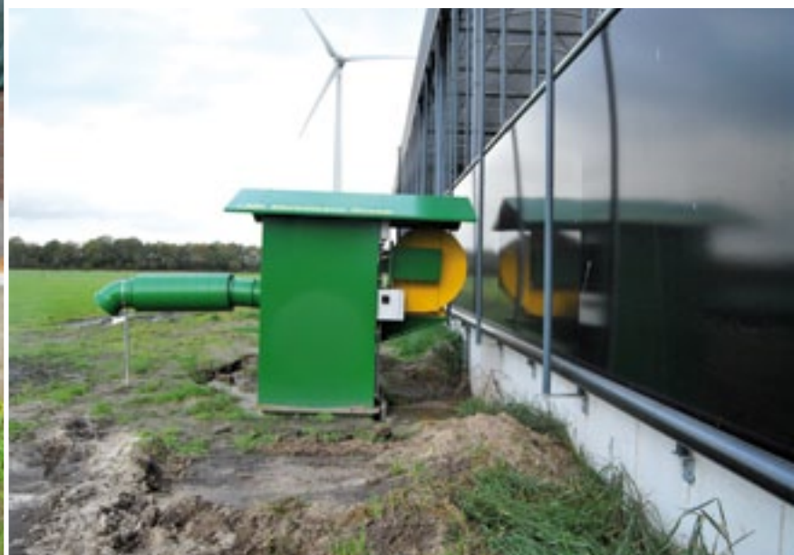
De ventilator die de stallucht door de bodem zuigt, staat naast de stal. De lucht die uit de pijp komt is warm en vochtig.
